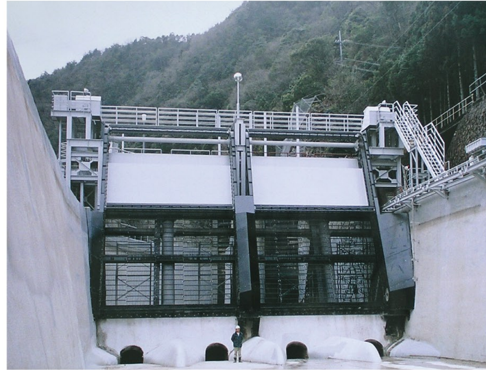
除塵機 | 業界: 電力 寸法: 16.1m×14.7m 材質: SUS304・SS400 重量: 131t
