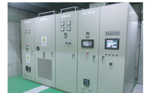
水車発電機盤
