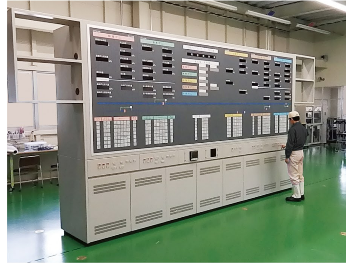
データ表示盤 | 業界: 電力 構成: 制御部・入出力部・表示部・操作部
