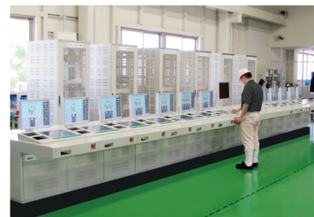
水門管理システム
