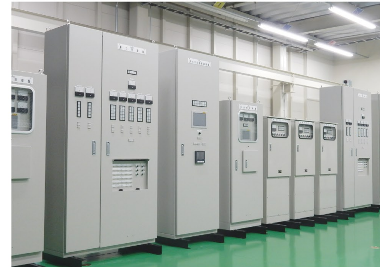
取水口自動制御装置 | 業界: 電力 構成: 制御部・表示部・動力制御部・操作部・保護センサ・計測
