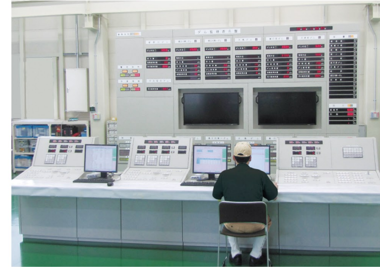
ダム統合管理システム | 業界: 電力 構成: 制御部・演算部・入出力部・表示部・操作部
