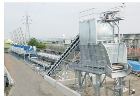
傾斜コンベヤ・ホッパー
