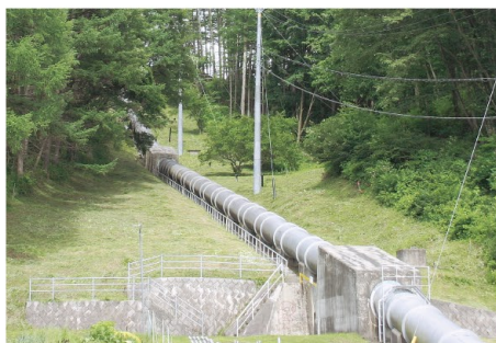
水力発電用水圧鉄管
